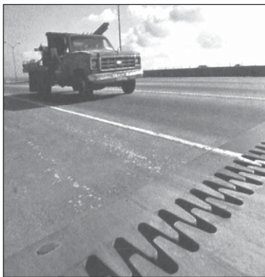
Gambar 3.6 Celah di antara dua lintasan jalan beton.
